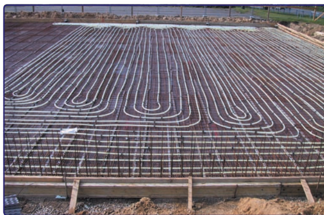
Dinotherm Industrieheizung im Autohaus Thülen, Aachen
